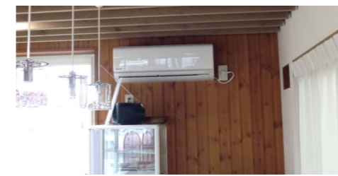
カフェのエアコン
